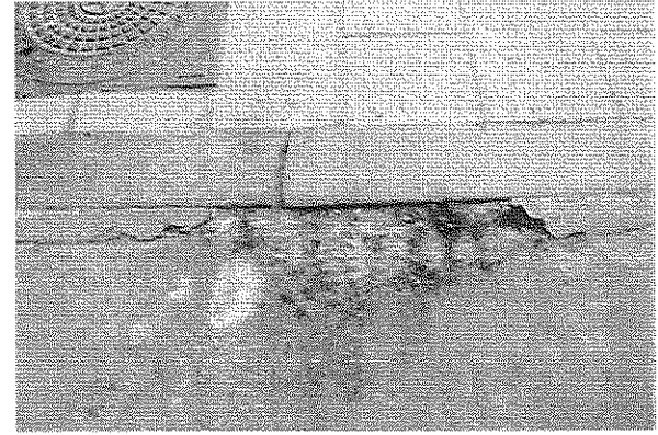
Skade i belægning ind til port
