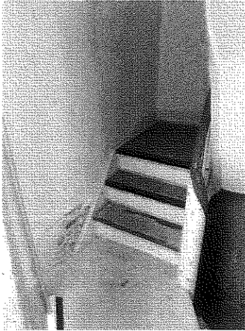
Løst puds og blottagt murværk.
