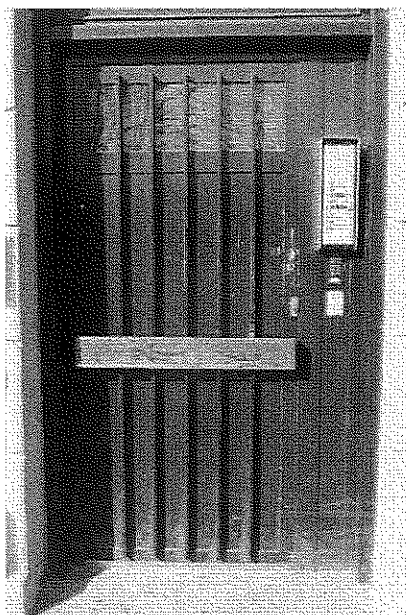
Dør mod gade, slidt men ok, rustskader i bunden
