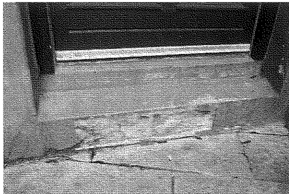
Skade under dør
