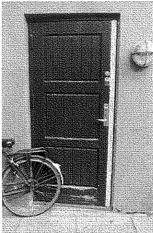
Lille dør mod vest, overfladiske skader
