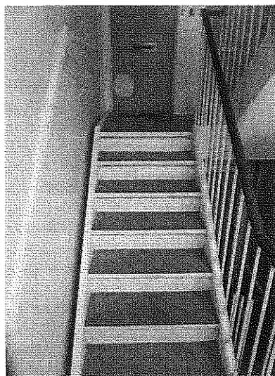
Trappe opgang 10, slidt linoleum i begge opgange
