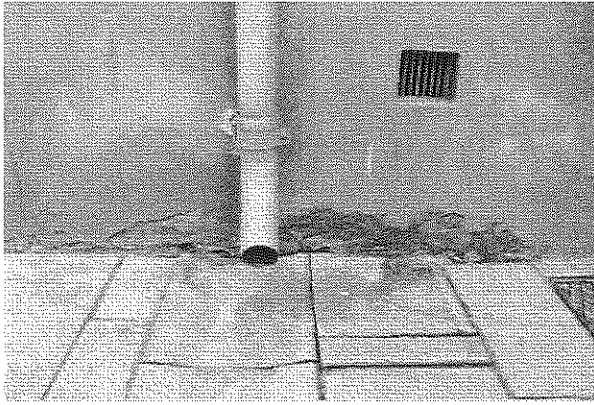
Skader ved nedløbsrør
