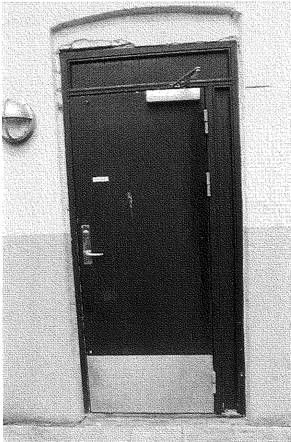
Dør mod gården, skader på døren og i pudset omkring døren
