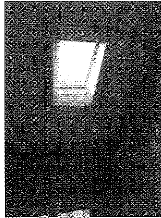
Vindue i loft over trappe, tegn på utæthed
