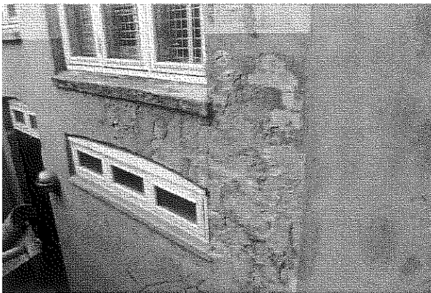
Skader på puds over kældernedgang
