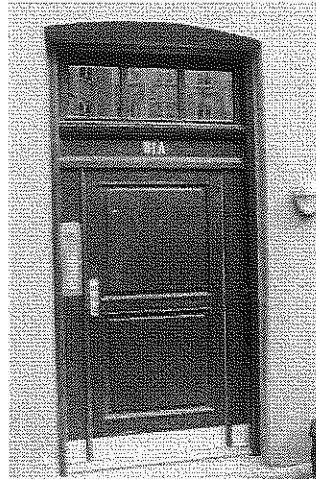
Skader omkring dør, 81A, mod vest
