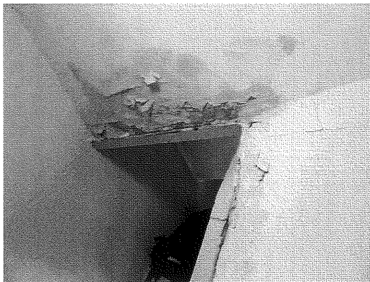
Fugt og vandskade efter vaskemaskine. Bitrappe bruges til tøjvask, tøjtørring og opmagasinerings.
