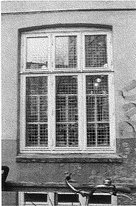
Bundrammer med krakleret overfladebehandling. Bemærk at bundrammen har sat sig. Gårdfacade
