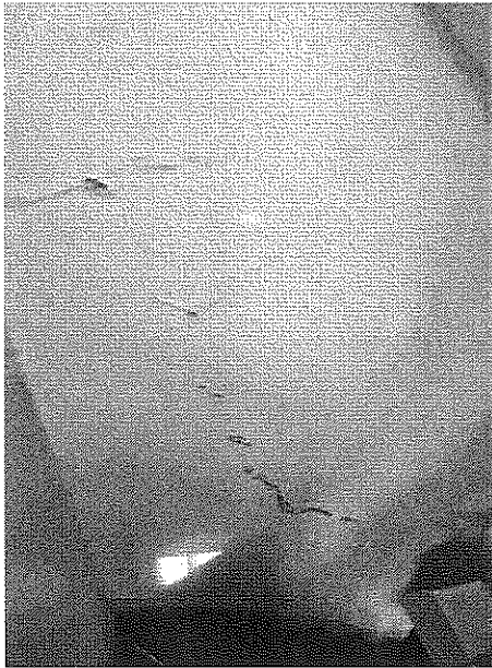
Revnedannelser i bitrapperum
