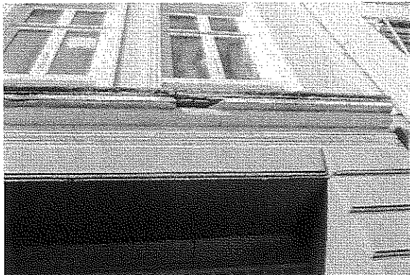
Skader på gesimsbånd
