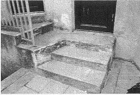
Trappe i gården fremstår slidt og med skader
