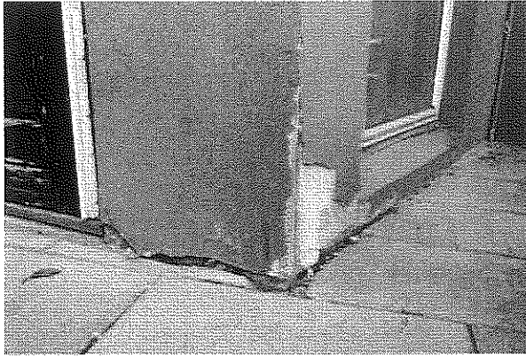
Skade på hjørnet, 81A
