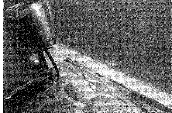
Skade ved sokkel
